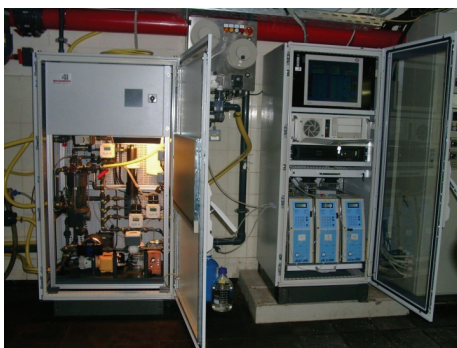
图 3 德国黑尔戈兰岛安装的 FerryBox 系统, 2003 年 Fig. 3 FerryBox system installed in Helgoland Island, Germany, 2003
