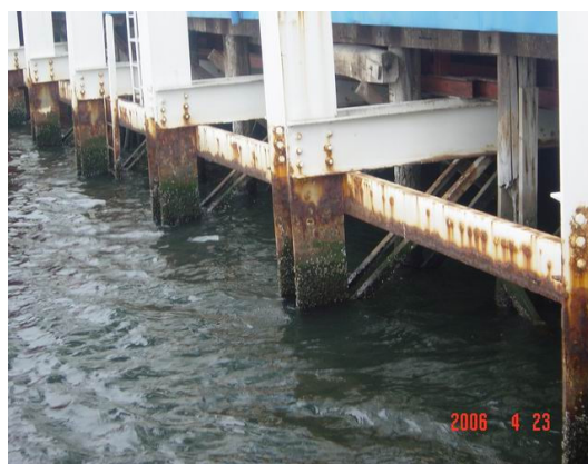
图 11 钢桩码头的腐蚀实例
