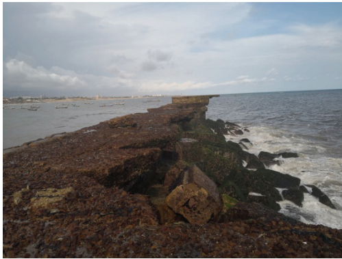
图3 加纳詹姆斯敦渔港防波堤损坏情况
